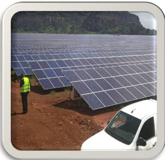
Centrale Solaire de Kita
